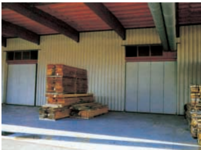
DELTOR FDP a 4 ante manuali montati su struttura in legno (TN)
